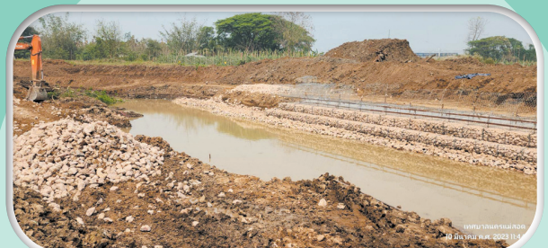
ลงพื้นที่ติดตามความคืบหน้าโครงการก่อสร้าง ระบบระบายน้ำหลัก ระยะที่ 2 อำเภอแม่สอด จังหวัดตาก
